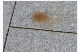
rostiger Splitt im Unterbau
